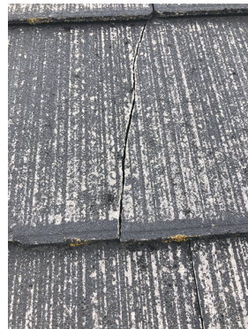
瓦の反りがみられ、一部割れていました。
