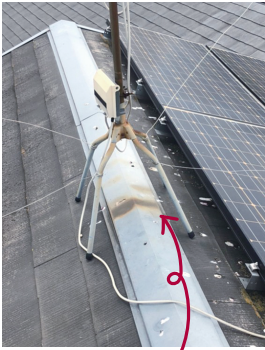
アンテナのもらい錆び
