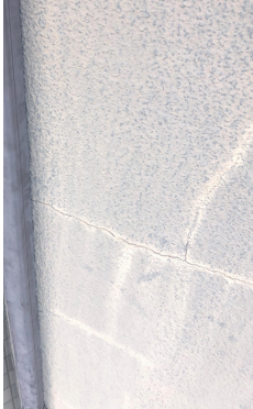
大きなヒビ割れはコーキング補修の跡がありました。
