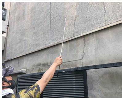
コンクリートの壁を打診棒で叩くと部位によって音が違います。これでタイル面を一枚ずつ叩いてタイルの浮きを確認することもできます。
