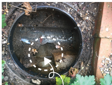
蓋を開けてみたら、底が割れていました!
