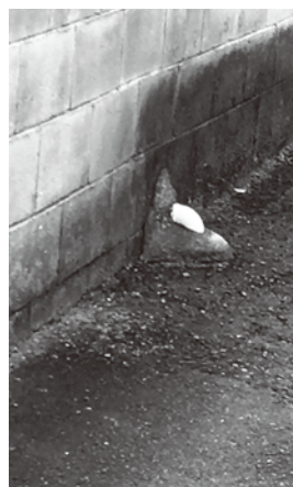
ブロック塀の外側、敷地外になる道路の下で詰まってました！
