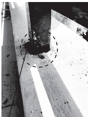
ベランダの鉄の支柱の根元 はすべてがこの様に錆びて 腐食し、ボコリ穴が！
