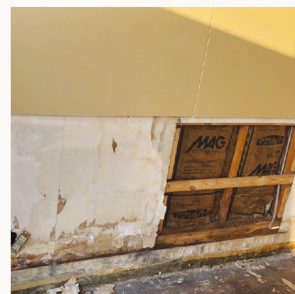
壁から雨漏れを発見！
