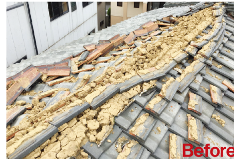
■地震直後の現場調査
